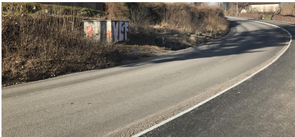
Befintlig nätstation. Utrymme för ny nätstation föreslås till höger om denna.
